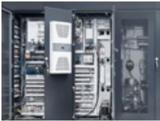
Klimatisierter Elektroschrank isoliert von Wärmequellen, mit einfachem Zugang.
